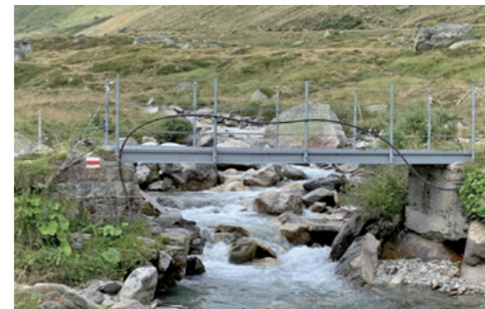
EINSTURZGEFÄHRDETE BRÜCKE VOR DER GRUNDSANIERUNG
