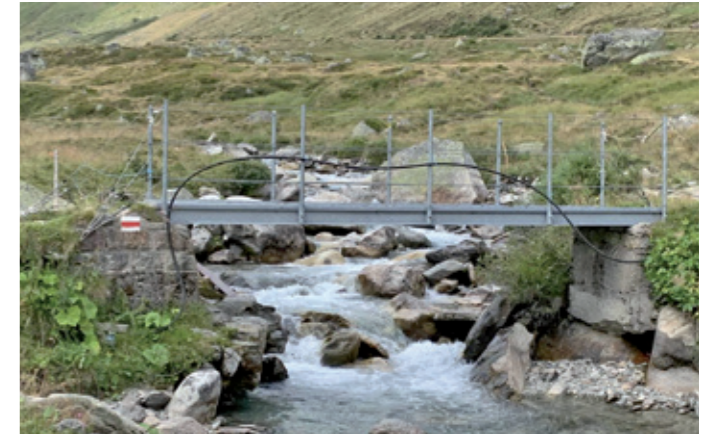
PONTE A RISCHIO DI CROLLO PRIMA DEL RISANAMENTO
