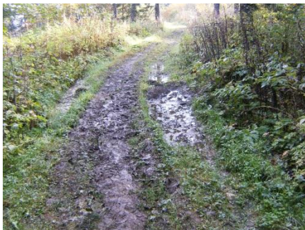
Beispiel eines schlecht entwässerten forstwirtschaftlich genutzten Weges.
